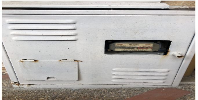
Contador de Gas
