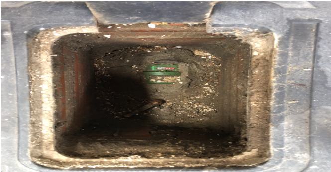
Contador de Agua
