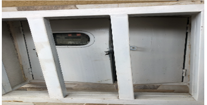
Contador de Energia
