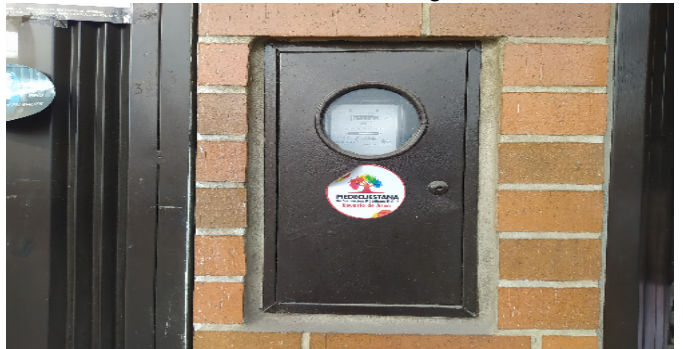
Contador de Energia
