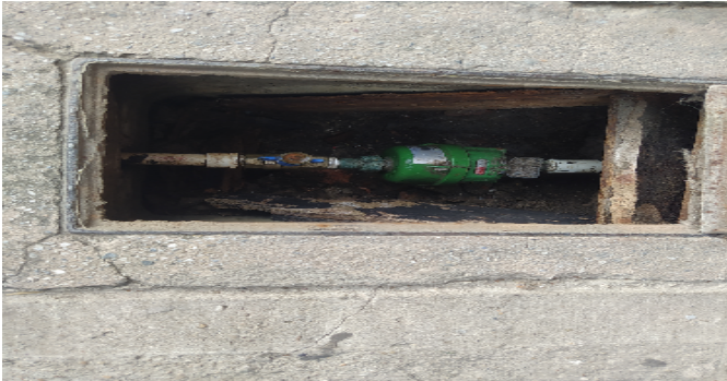
Contador de Agua
