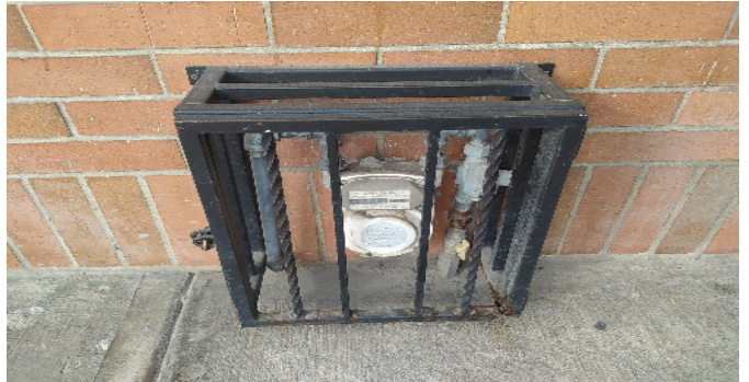
Contador de Gas
