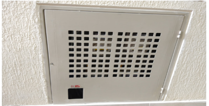
Contador de Gas
