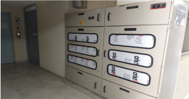
Contador de Energia
