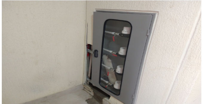
Contador de Agua
