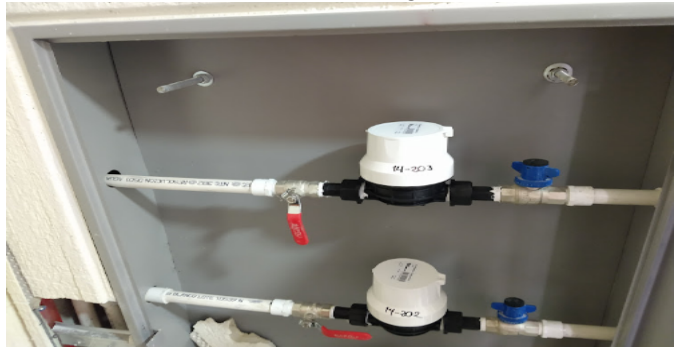
Contador de Agua
