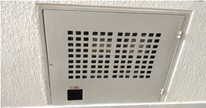
Contador de Gas
