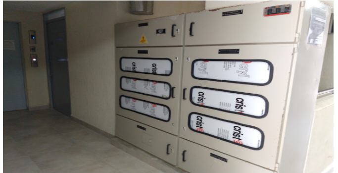
Contador de Energia
