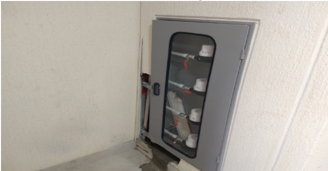
Contador de Agua
