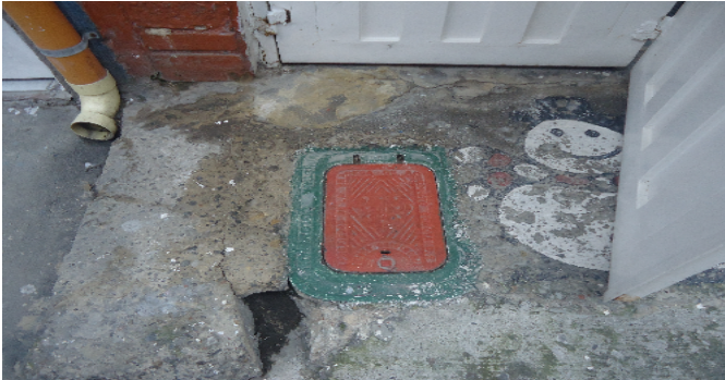
Contador de Agua
