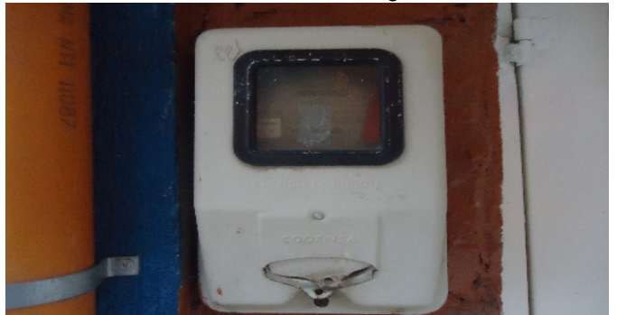
Contador de Energia
