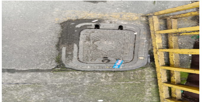
Contador de Agua
