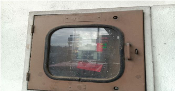
Contador de Energia
