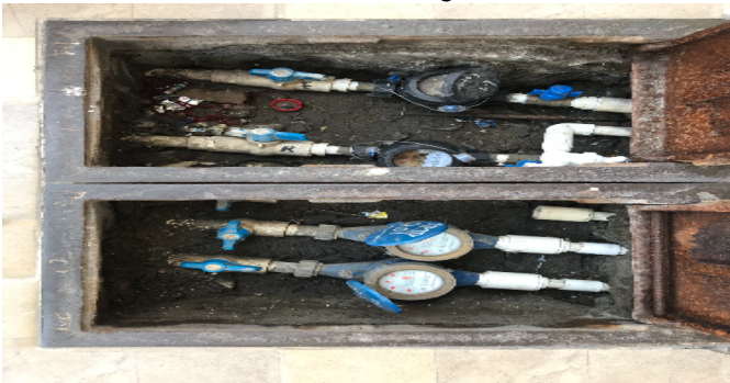
Contador de Agua
