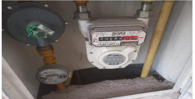
Contador de Gas
