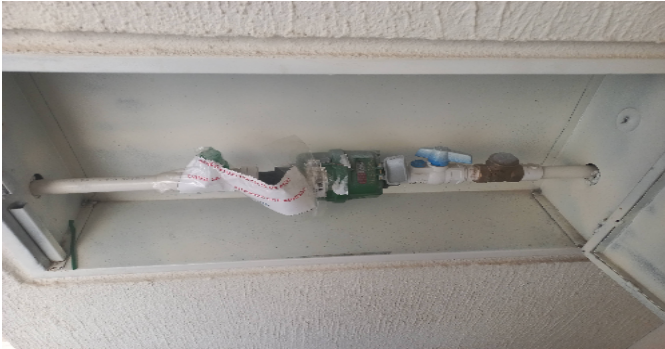
Contador de Agua
