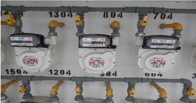
Contador de Gas
