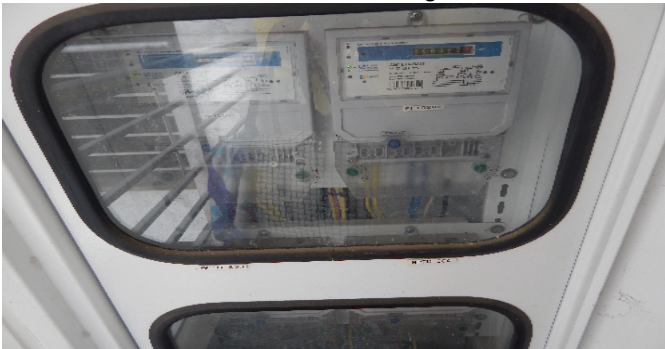
Contador de Energia
