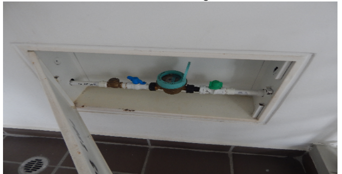
Contador de Agua
