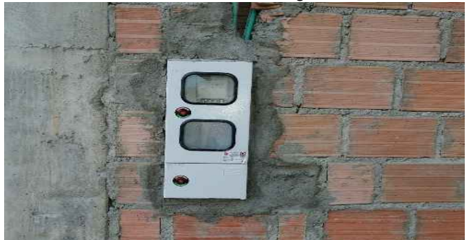
Contador de Energia
