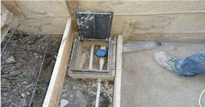
Contador de Agua
