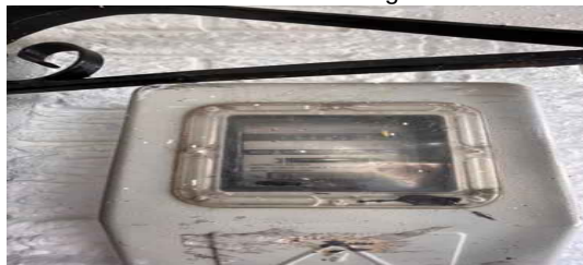
Contador de Energia
