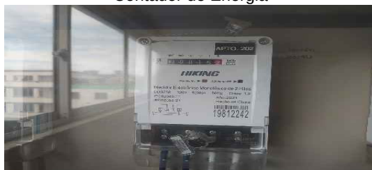
Contador de Energia
