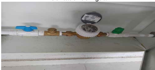
Contador de Agua
