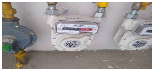
Contador de Gas
