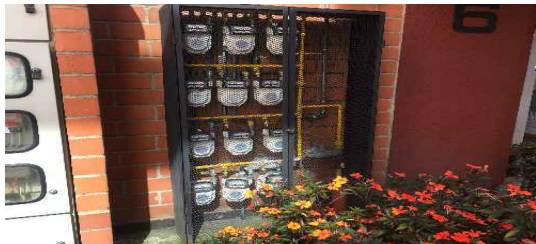
Contador de Gas
