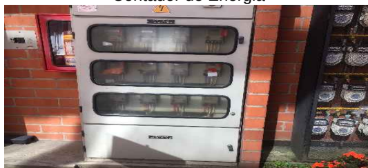
Contador de Energia
