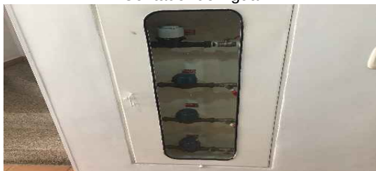
Contador de Agua
