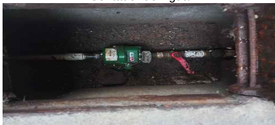
Contador de Agua
