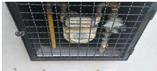
Contador de Gas
