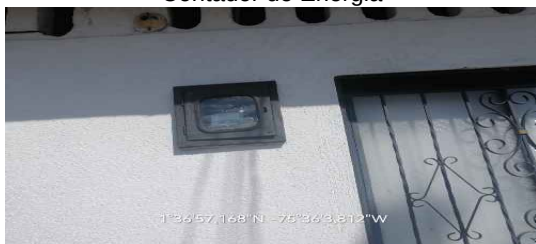
Contador de Energia
