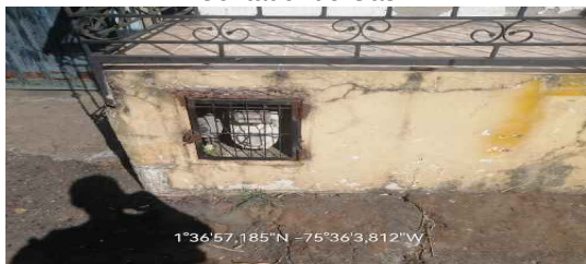
Contador de Gas
