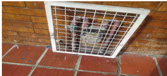
Contador de Gas
