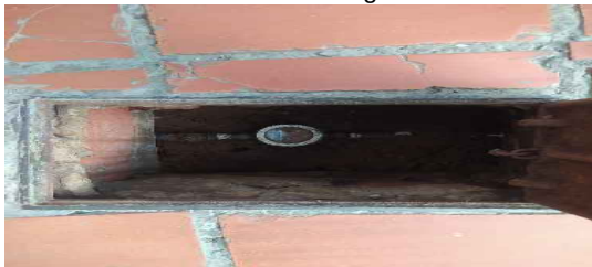
Contador de Agua
