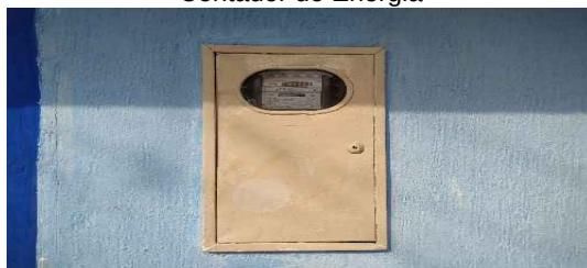
Contador de Energia
