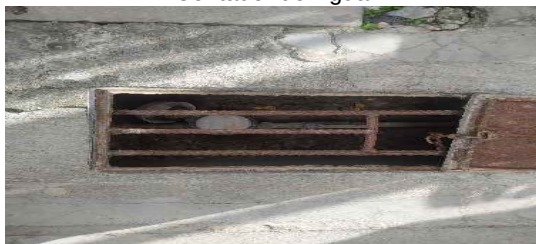
Contador de Agua
