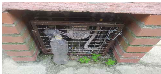
Contador de Gas
