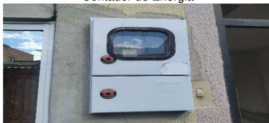
Contador de Energia
