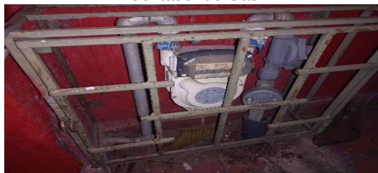
Contador de Gas
