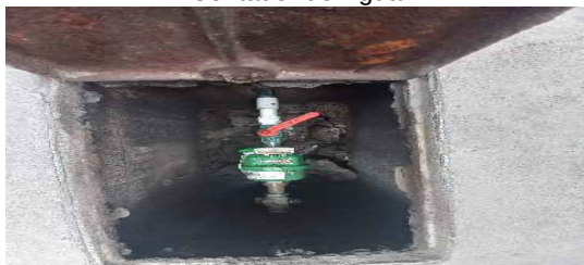
Contador de Agua
