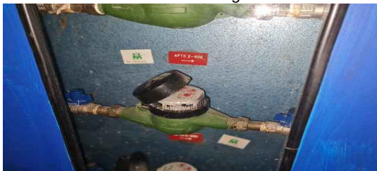
Contador de Agua
