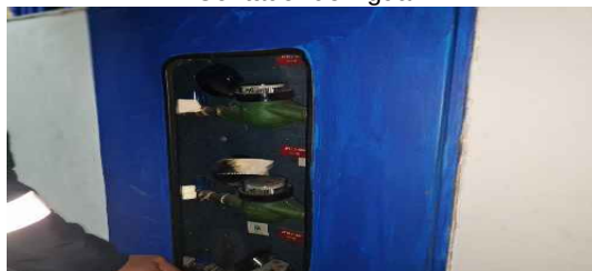
Contador de Agua
