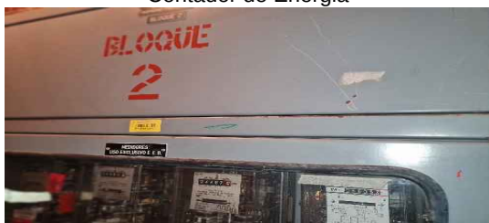
Contador de Energia
