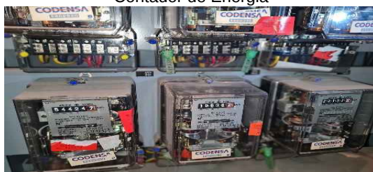
Contador de Energia
