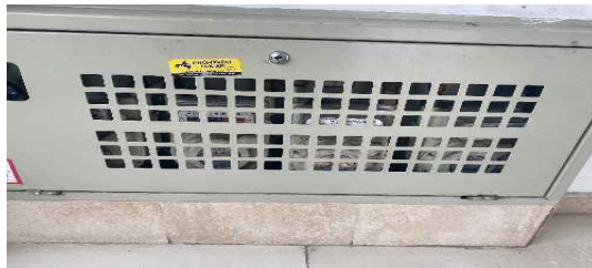
Contador de Gas
