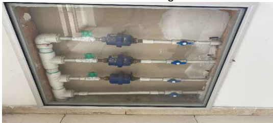
Contador de Agua
