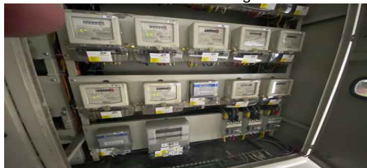
Contador de Energia
