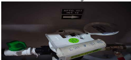
Contador de Agua
