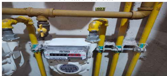
Contador de Gas
