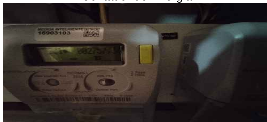
Contador de Energia
