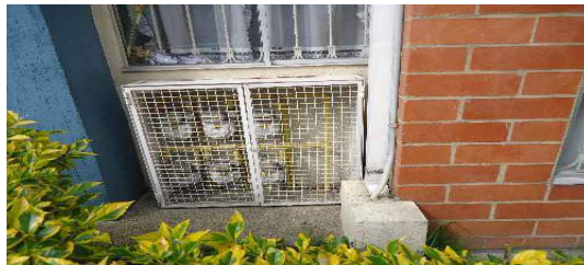
Contador de Gas
