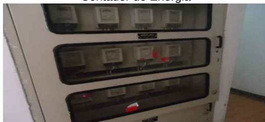
Contador de Energia
