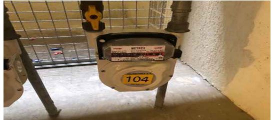
Contador de Gas
