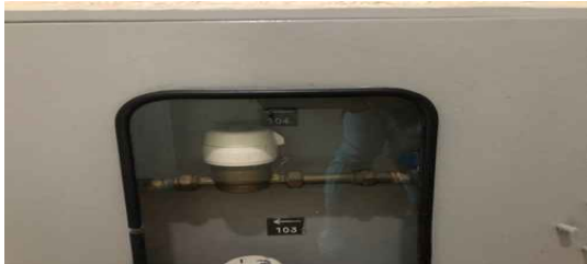
Contador de Agua
