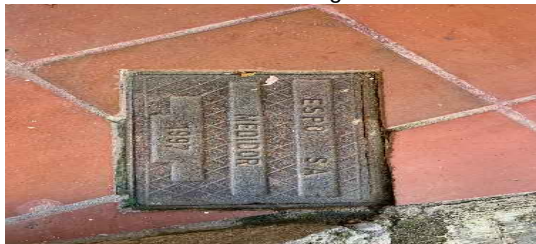
Contador de Agua
