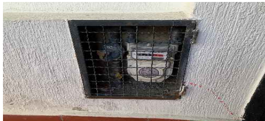
Contador de Gas
