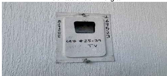
Contador de Energia
