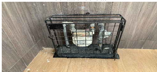
Contador de Gas
