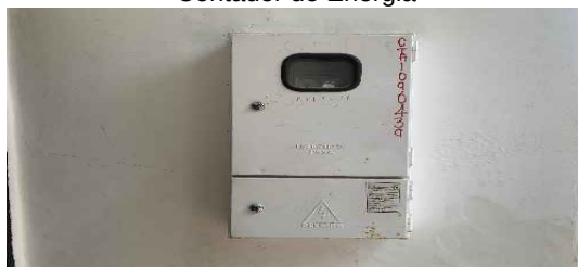
Contador de Energia
