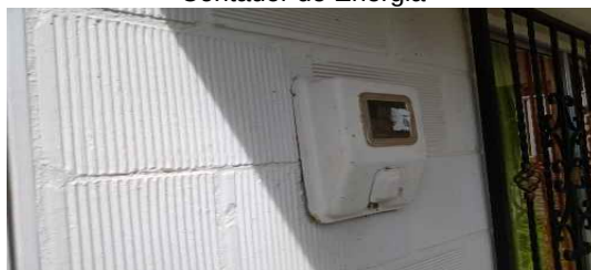
Contador de Energia
