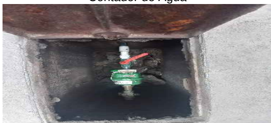
Contador de Agua
