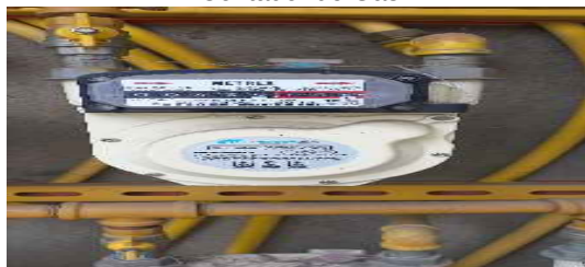
Contador de Gas
