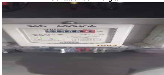
Contador de Energia
