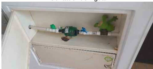
Contador de Agua
