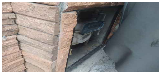
Contador de Gas
