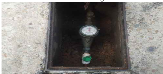
Contador de Agua
