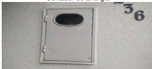
Contador de Energia
