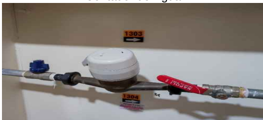
Contador de Agua
