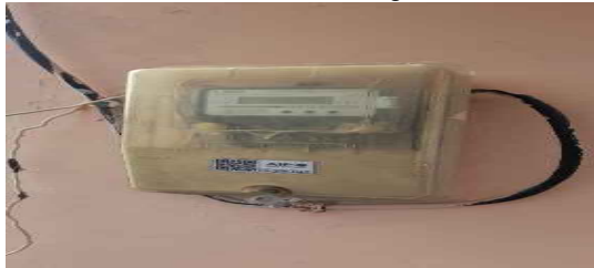
Contador de Energia
