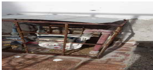
Contador de Gas
