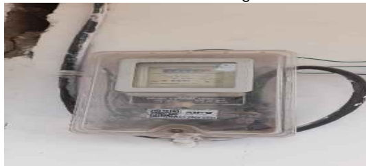
Contador de Energia
