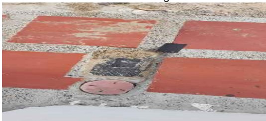
Contador de Agua
