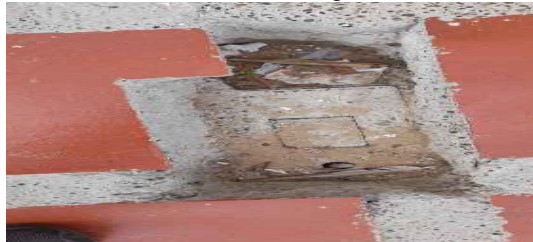
Contador de Agua
