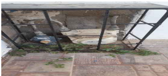
Contador de Gas
