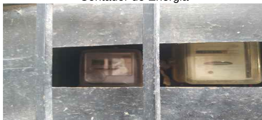
Contador de Energia
