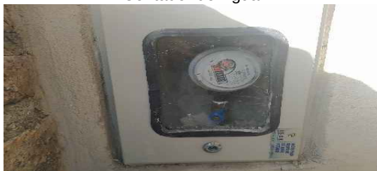
Contador de Agua
