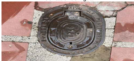
Contador de Agua
