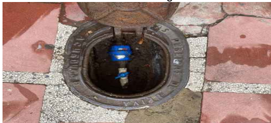
Contador de Agua
