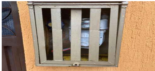
Contador de Gas
