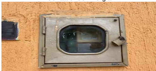
Contador de Energia
