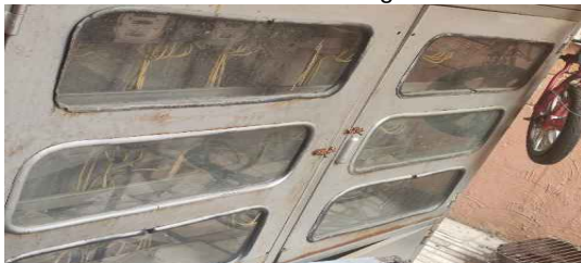
Contador de Energia
