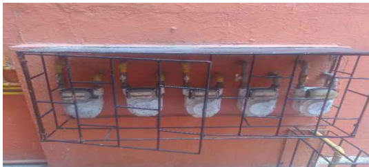
Contador de Gas
