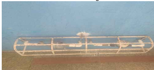
Contador de Agua
