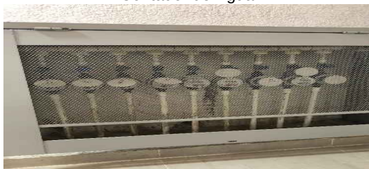
Contador de Agua
