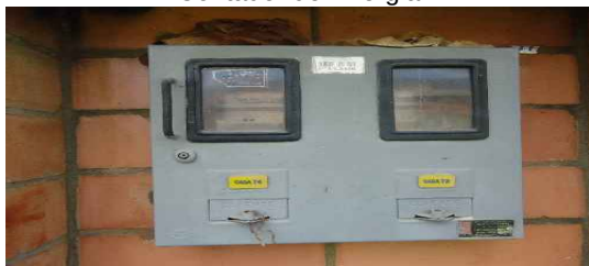
Contador de Energia
