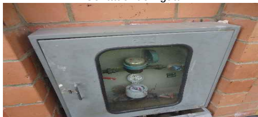
Contador de Agua
