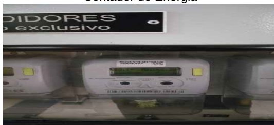
Contador de Energia
