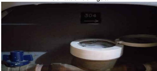
Contador de Agua
