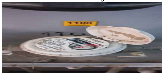
Contador de Agua
