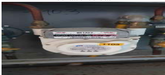
Contador de Gas
