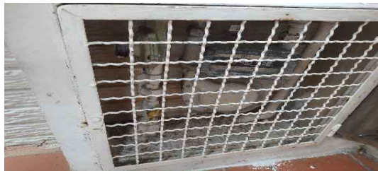
Contador de Gas
