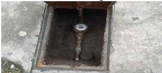
Contador de Agua
