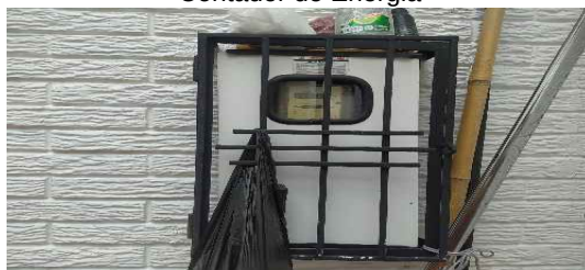
Contador de Energia
