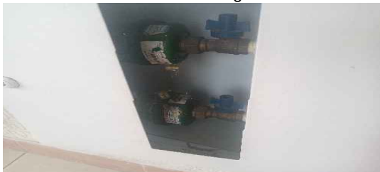
Contador de Agua
