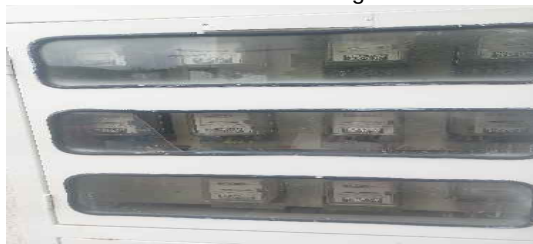
Contador de Energia
