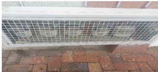
Contador de Gas
