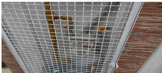
Contador de Gas
