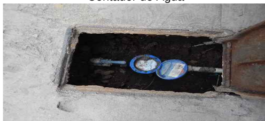
Contador de Agua
