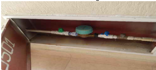
Contador de Agua
