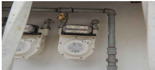
Contador de Gas
