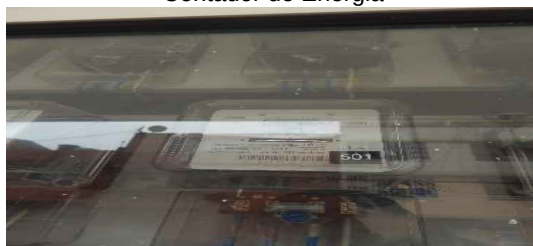
Contador de Energia
