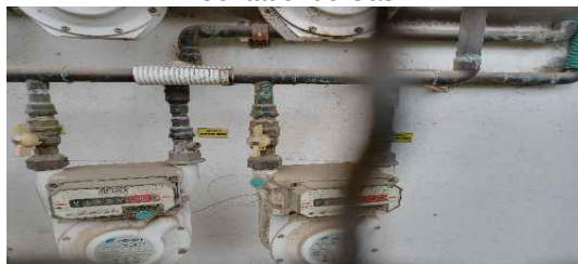
Contador de Gas
