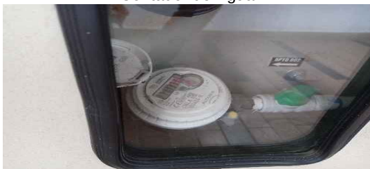
Contador de Agua
