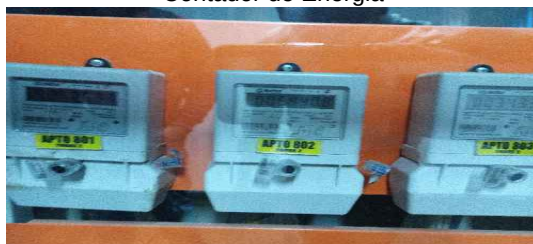
Contador de Energia
