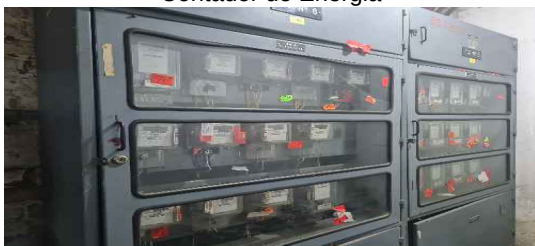
Contador de Energia
