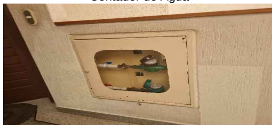
Contador de Agua
