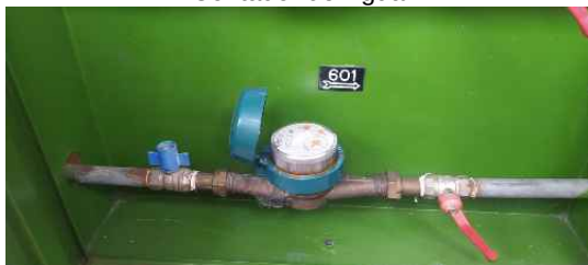
Contador de Agua
